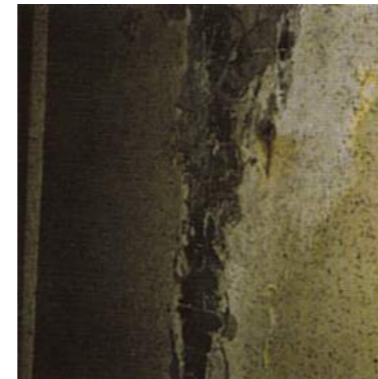
セメントアルカリによる塗料の加水分解
