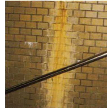
鉄骨の発錆による破裂と錆汁
